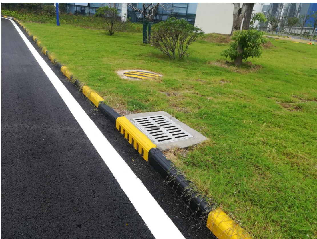
图片 10 厂区雨水口雨水井
